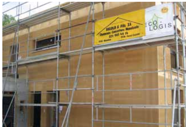
Étape 1 : isolation rigide en fibres de bois à crépir / architecte et MO : Bernard Kuhn / maison en ossature bois et isolation paille à Vauderens
