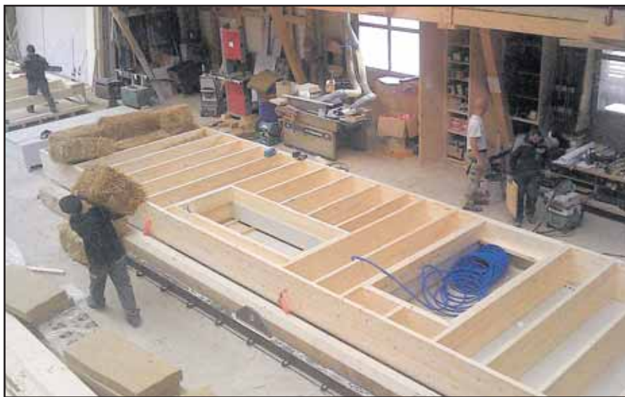
Fabrication des ossatures en bois en atelier avec mise en place des bottes de paille.
